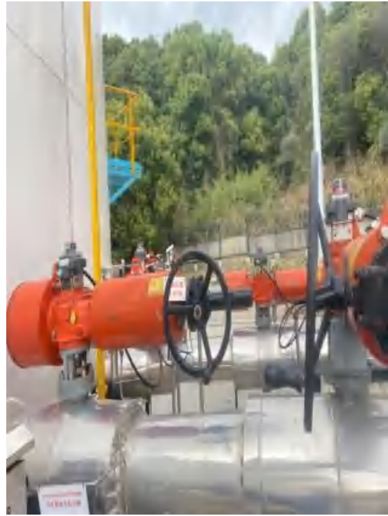
五号罐区苯罐配套设施
