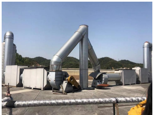
2套“喷淋净化塔+过滤+干燥+UV光解催化 设备+活性炭吸附”装置
